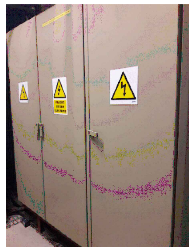
Imagen CUADRO ELÉCTRICO 04 POLIDEPORTIVO Y PISCINA
