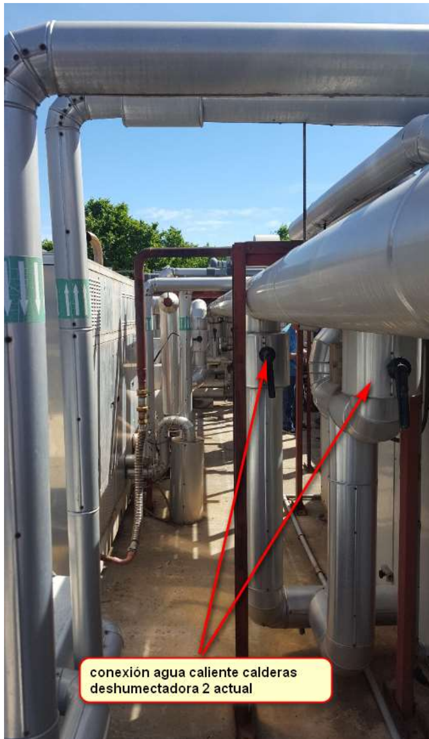
Imagen-7 conexión actual circuito agua caliente calderas deshumectadora -2
