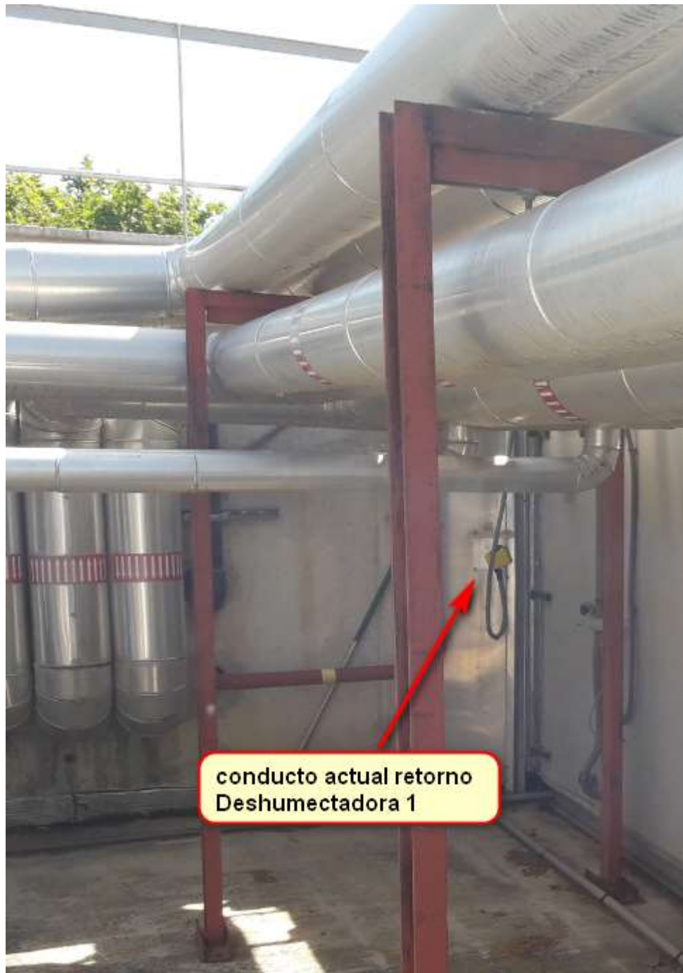
Imagen-4 Conducto actual retorno Zona técnica planta 1.
