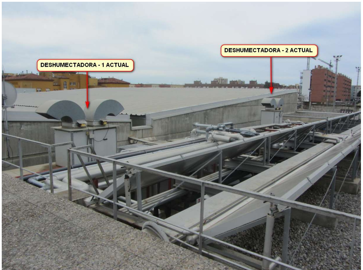
Imagen-12 - Deshumectadoras actuales a desmontar Zona técnica planta 1.
