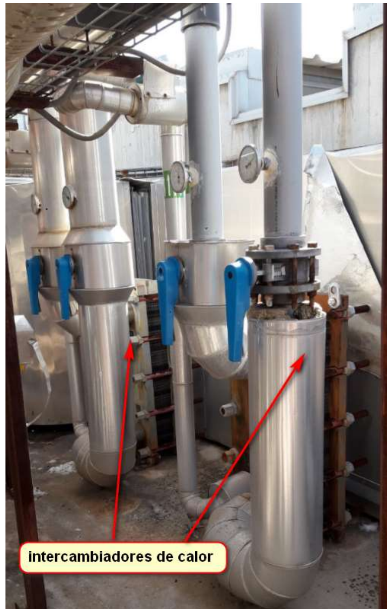
Imagen-16 - Equipos actuales a desmontar Zona técnica planta 1.
