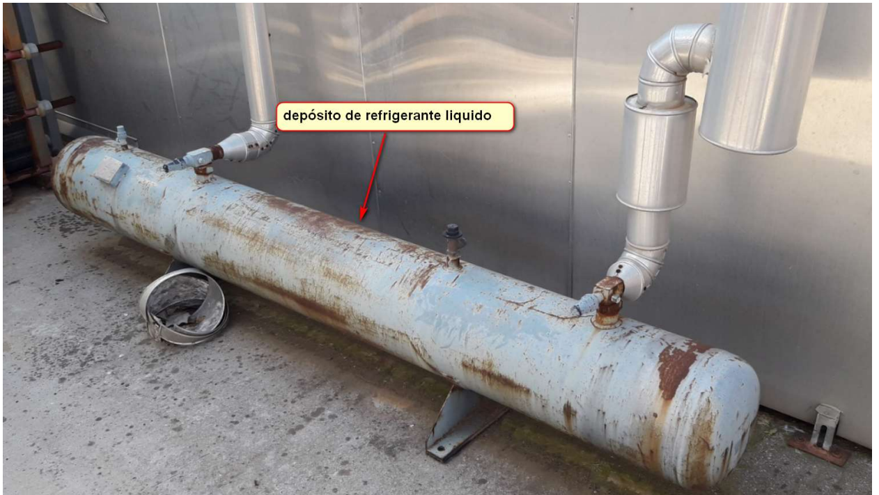
Imagen-17 - Equipos actuales a desmontar Zona técnica planta 1.
