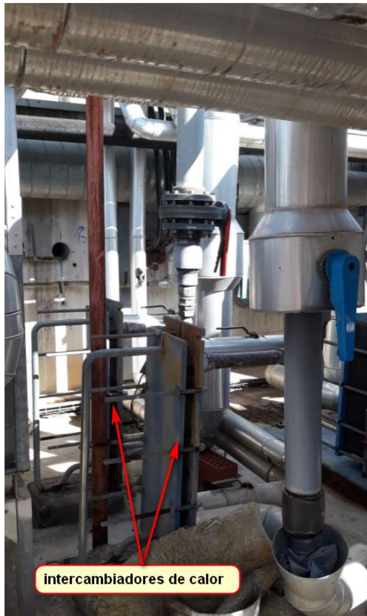
Imagen-15 - Equipos actuales a desmontar Zona técnica planta 1.
