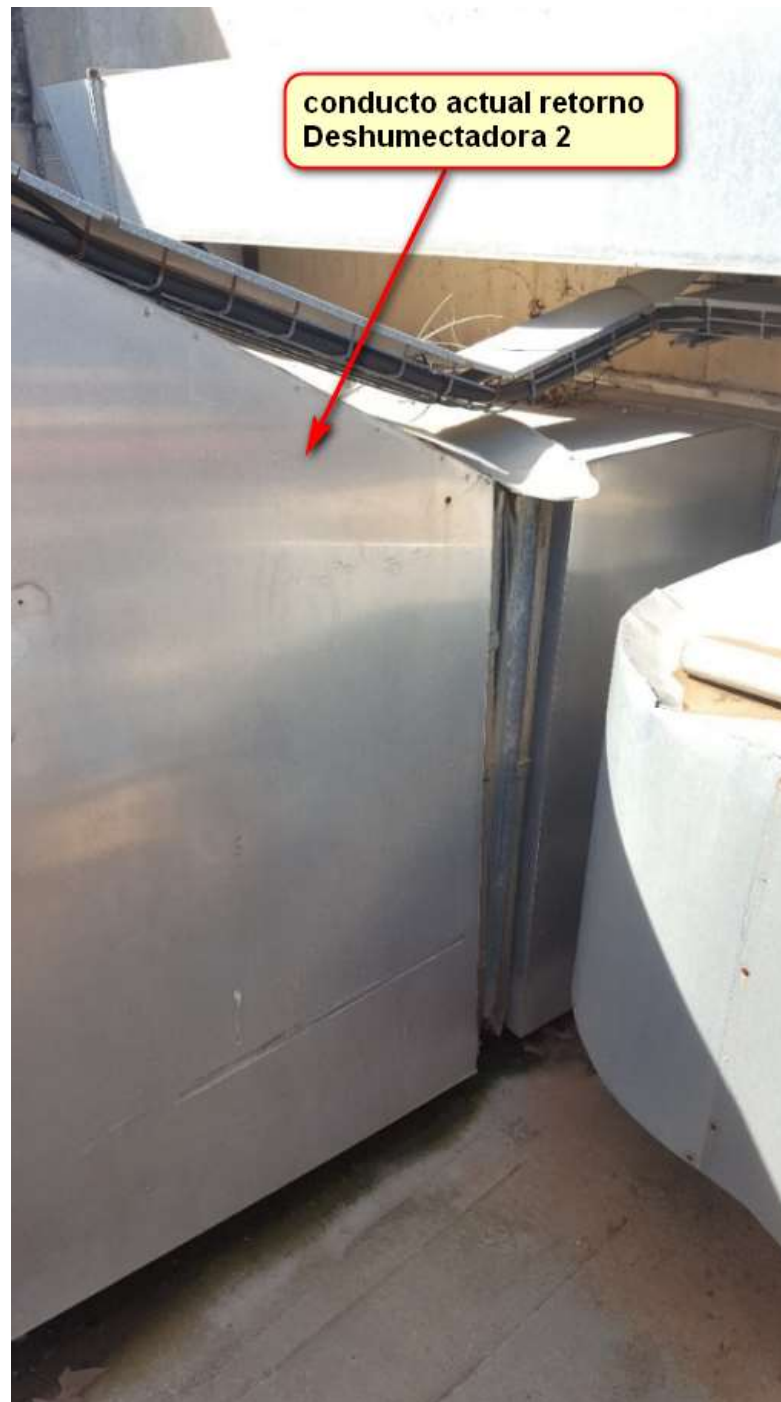
Imagen-3 Conducto actual retorno Zona técnica planta 1.
