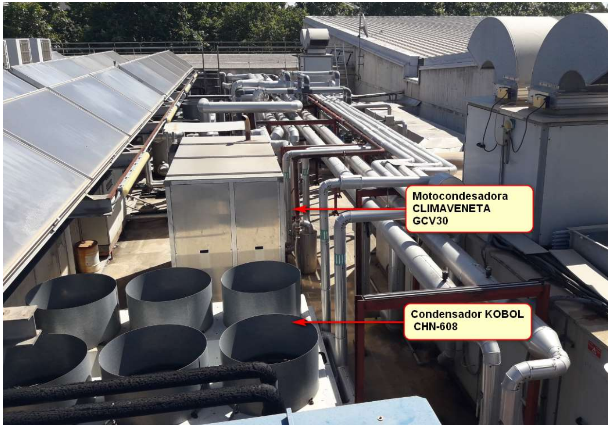
Imagen-13 - Equipos actuales a desmontar Zona técnica planta 1.
