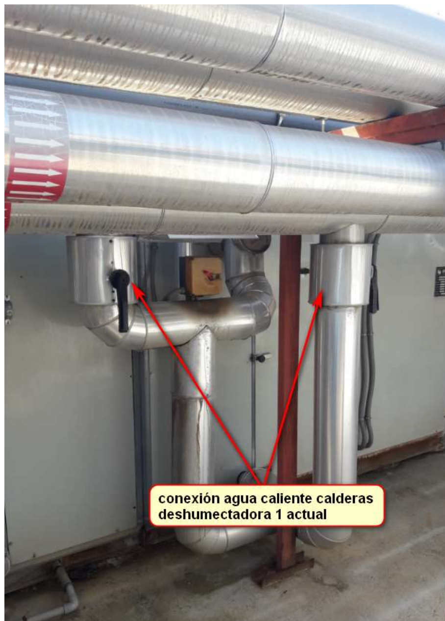
Imagen-6 conexión actual circuito agua caliente calderas deshumectadora -1
