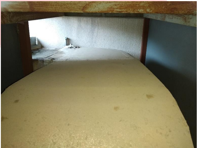
Imatge1-46. Equip RoofTop Zona A - Polifuncional – Conducte de retorn imatge interior del "Patinillo".
