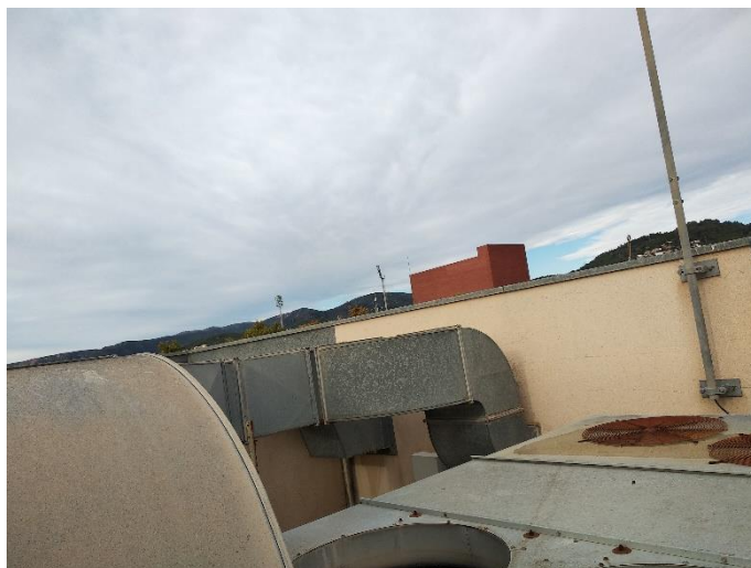
Imatge1-29. Equip RoofTop Zona F - Sala Adults triple altura – Vista superior Conducte d'impulsió tipus "Pantaló".
