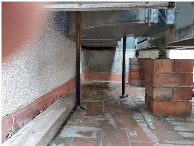
Imatge1-47. Equip RoofTop Zona A - Polifuncional – Conducte d'impulsió part inferior.
