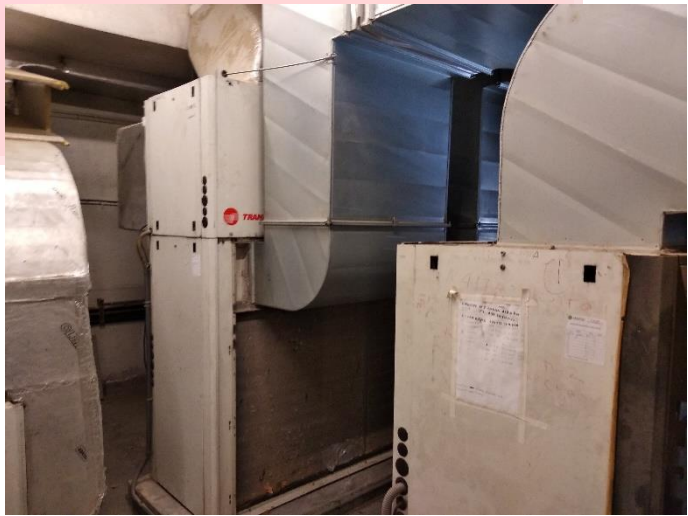
Imatge1-23. Equip climatització Zona G - Planta Altell - Trane RXC+BPH/250. - Aspiració Plenum i descarrega horitzontal.
