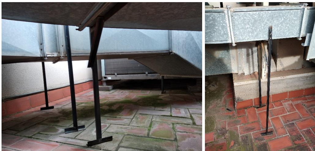
Imatge1-50. Vista general de bancades de suport conductes.
