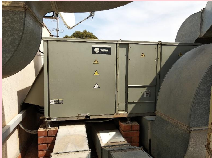
Imatge1-33. Equip RoofTop Zona E - Hall - Vista general.
