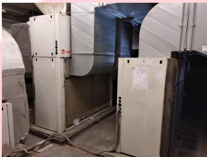
Imatge1-25. Equips climatització Zona G i C – Vista general sobre bancades.
