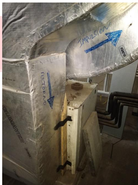
Imatge1-20. Equip climatització Zona C - Planta Baixa - Trane RXC+BPH/200 – U. Int. Impulsió vertical Retorn Horitzontal.
