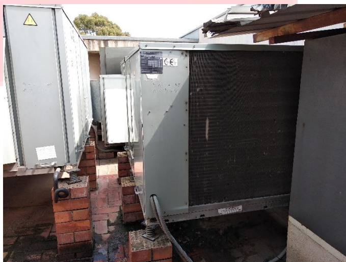
Imatge1-43. Equip RoofTop Zona A - Polifuncional - Vista general.
