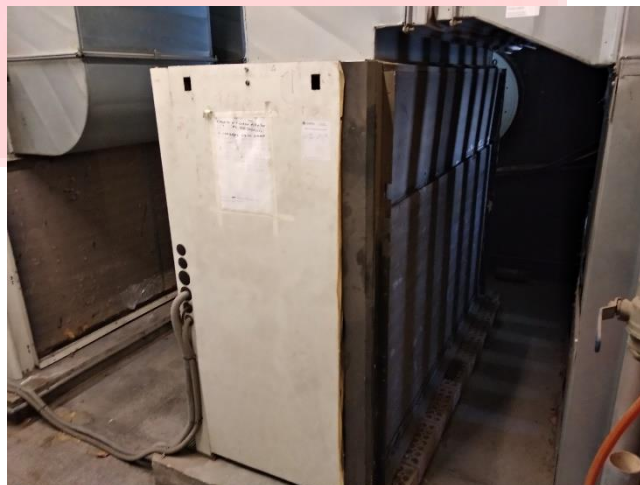
Imatge1-17. Equip climatització Zona C - Planta Baixa - Trane RXC+BPH/200 Aspiració per Plenum
