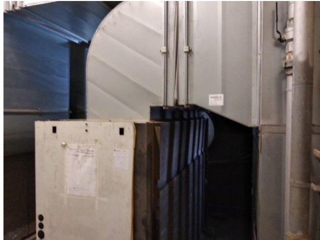
Imatge1-18. Equip climatització Zona C - Planta Baixa - Trane RXC+BPH/200 - Vista lateral conducte descarrega. U Ext.
