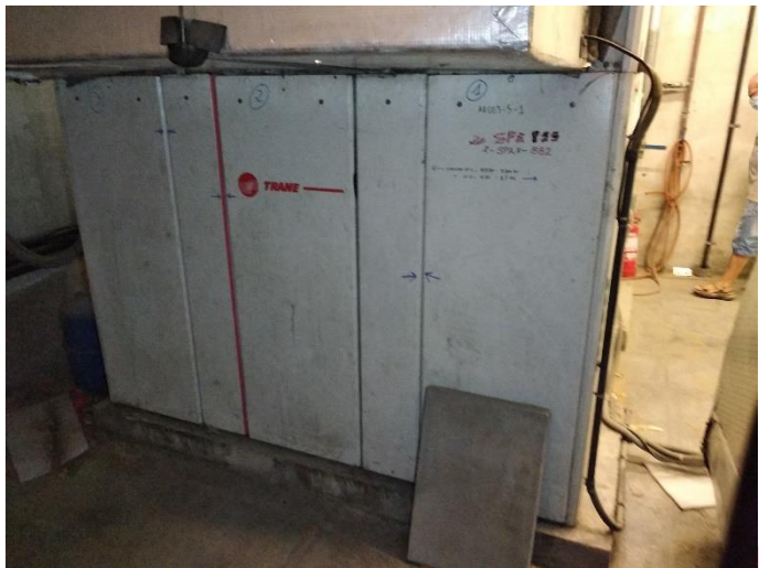
Imatge1-21. Equip climatització Zona G - Planta Altell - Trane RXC+BPH/250. Compacte.
