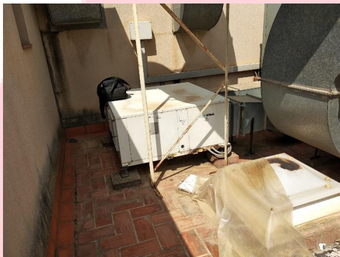
Imatge1-48. Equip compacte Zona D - Oficines - ROCA BCH - 100
