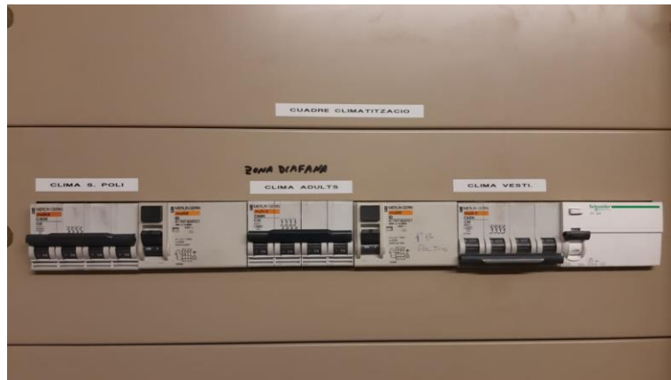
Imatge1-12. Proteccions tèrmiques i diferencials equips climatització Polifuncional, Sala Adults TA i Hall.
