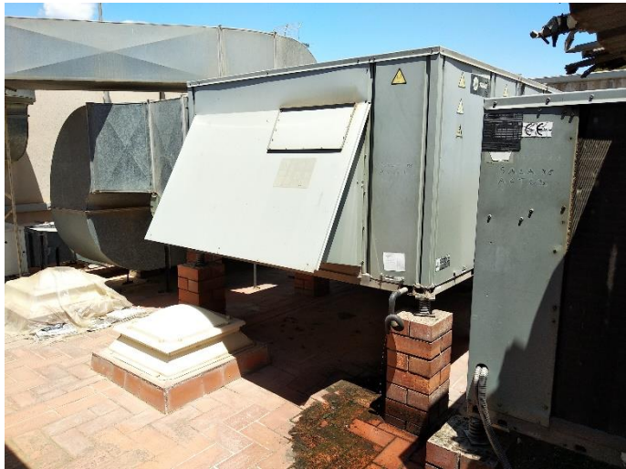
Imatge1-27. Equip RoofTop Zona F - Sala Adults triple altura - Vista general.
