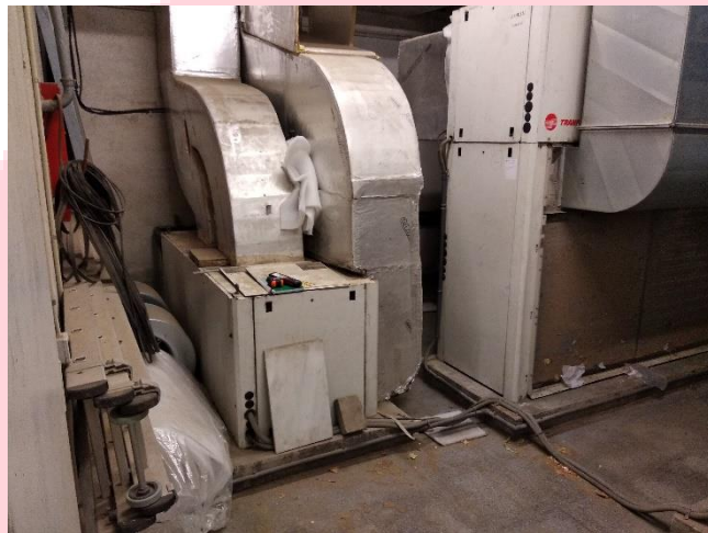
Imatge1-19. Equip climatització Zona C - Planta Baixa - Trane RXC+BPH/200 – Unitat interior
