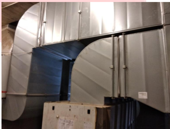
Imatge1-26. Conducció de descarrega unitats exteriors.
