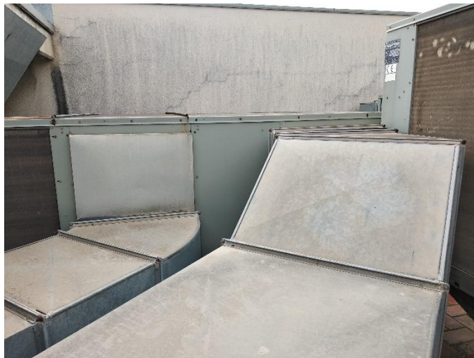
Imatge1-41. Equip RoofTop Zona B Sala Infantil – Conductes d'impulsió i retorn.
