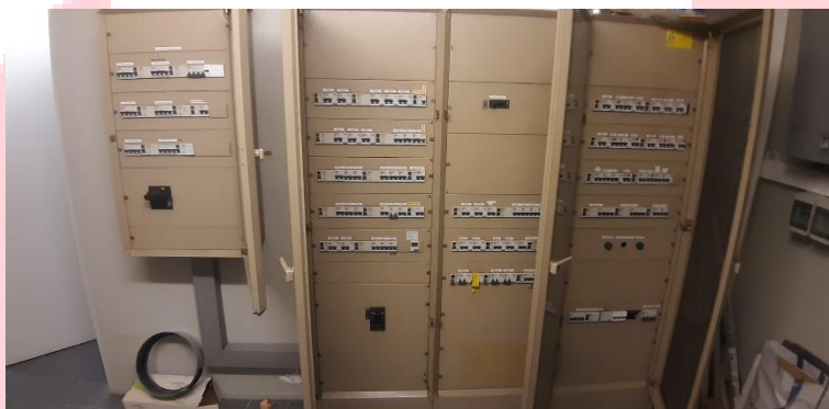
Imatge1-10. Vista general quadres elèctrics – Ubicació quadre climatització Esquerra.
