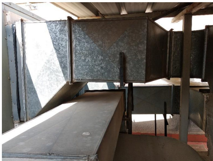
Imatge1-35. Equip RoofTop Zona E - Hall - Conducte d'impulsió.
