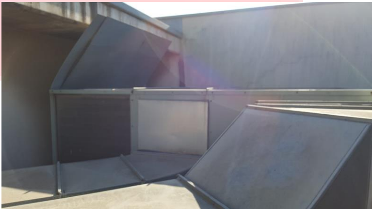
Imatge1-40. Equip RoofTop Zona B Sala Infantil - Vista lateral.
