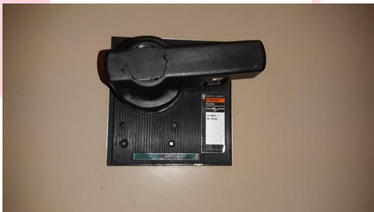
Imatge1-11. Seccionador general sub-quadre climatització.
