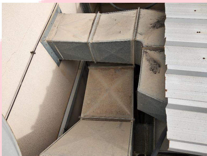
Imatge1-36. Equip RoofTop Zona E - Hall - Conducte inferior de retorn i derivació de conducte d'impulsió per paret.
