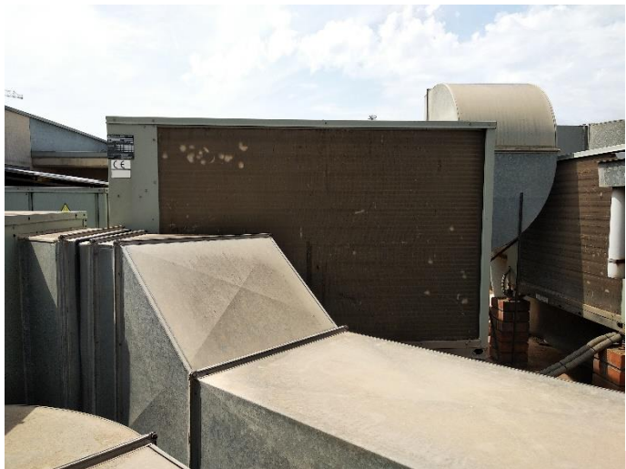
Imatge1-32. Equip RoofTop Zona F - Sala Adults triple altura. Vista darrera bateries de condensació.
