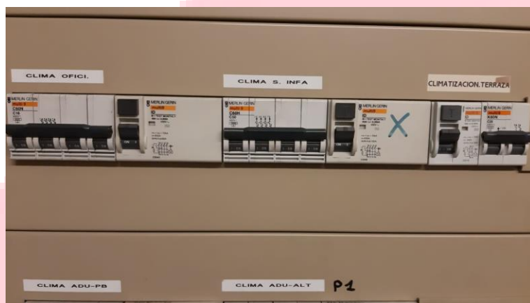
Imatge1-13. Proteccions tèrmiques i diferencials equips climatització Oficines i Sala Infantil
