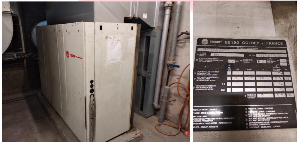
Imatge1-16. Equip climatització Zona C - Planta Baixa - Trane RXC+BPH/200 – Descàrrega vertical.
