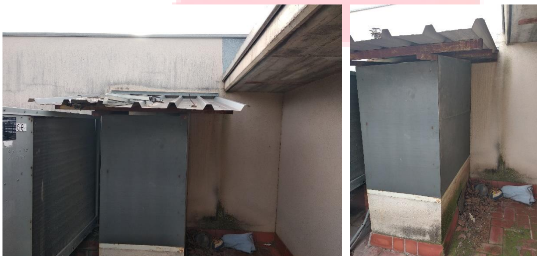
Imatge1-51. Coberta de protecció "Patinillo" de conduccions d'impulsió i retorn cap a Zona A - Sala Polifuncional.
