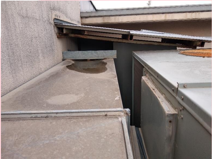
Imatge1-45. Equip RoofTop Zona A - Polifuncional – Conducte de retorn.
