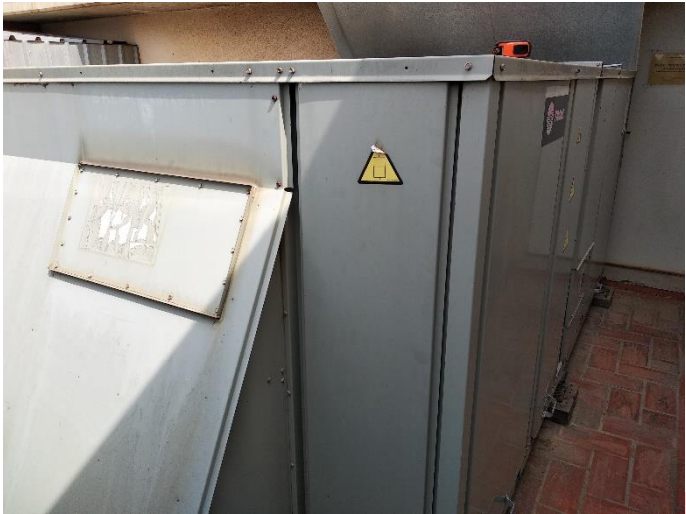
Imatge1-38. Equip RoofTop Zona B Sala Infantil - Vista general.
