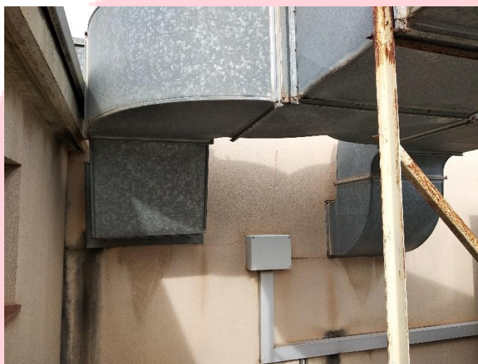
Imatge1-30. Equip RoofTop Zona F - Sala Adults triple altura – Vista inferior Conducte d'impulsió tipus "Pantaló".
