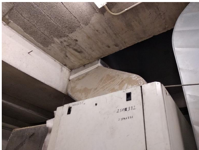
Imatge1-24. Equip climatització Zona G - Planta Altell - Trane RXC+BPH/250. – Conducció impulsó vertical.
