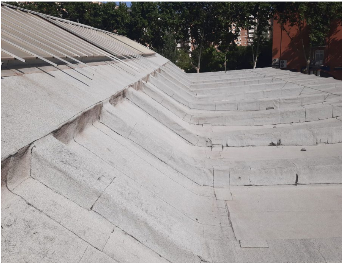
Figura 7: Detalle del estado de la cubierta
