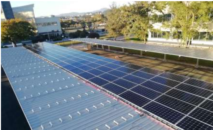
Exemple d'instal·lació solar fotovoltaica coplanar sobre mènsula doble
