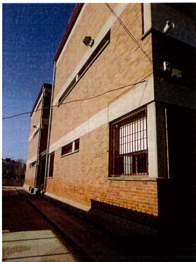
Imagen del estado actual del testero sur del edificio de educación primaria
